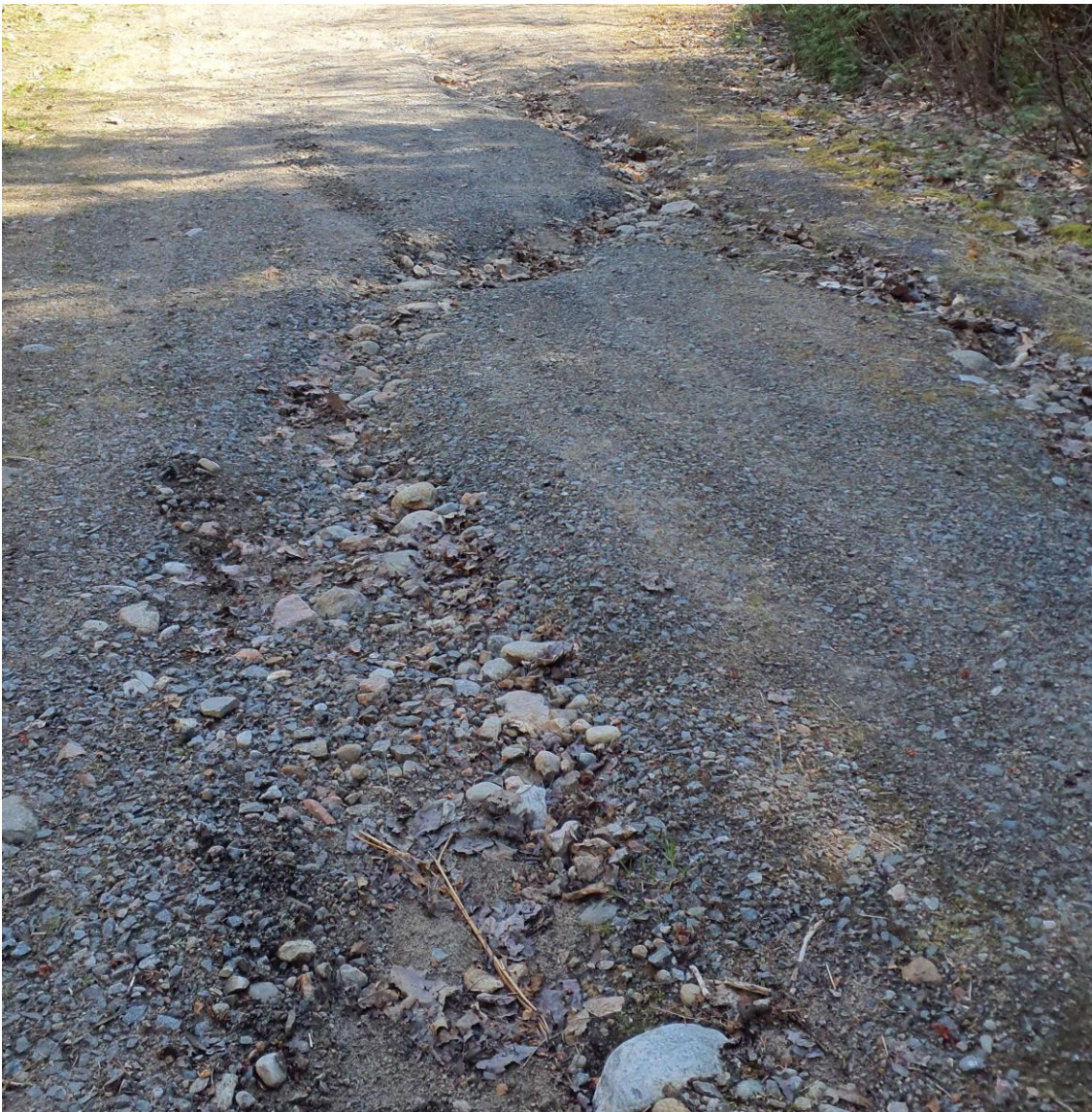
Figure 6 : Exemple de ravinement causé par du ruissellement de surface observé au milieu d'une entrée charretière (Lam-Er-02) au lac Lambert, 2024
