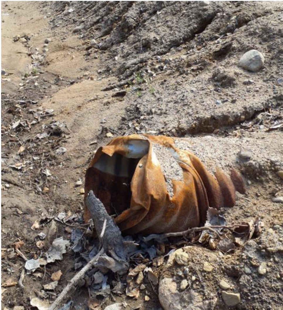
Figure 14 : Exemple de ponceau très détérioré et sans aucune stabilisation (Lam-Pon-02) sur le boulevard Alexandre, lac Lambert 2024
