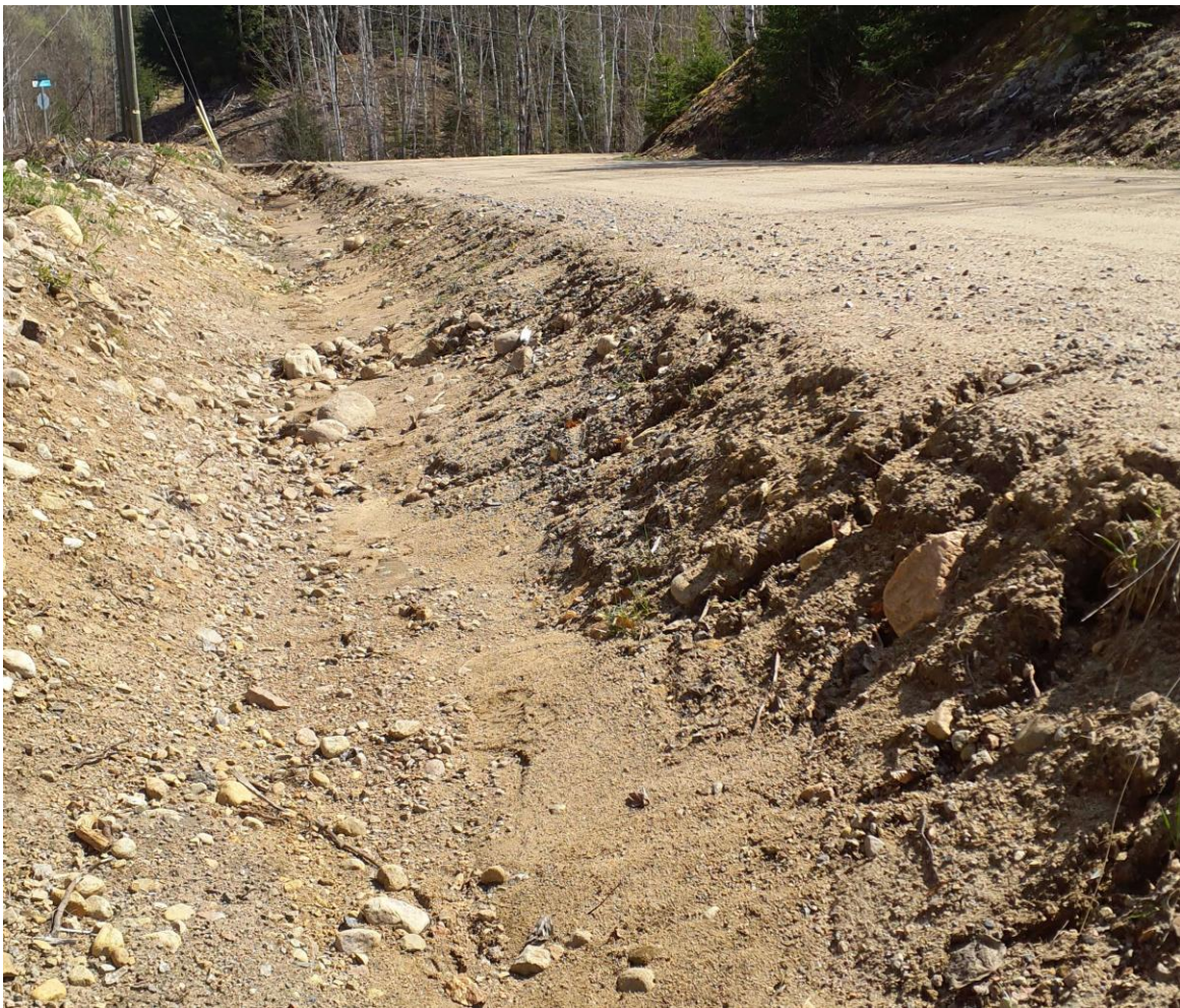
Figure 7 : Exemple de chemin à proximité du lac Lambert subissant de l'affaissement (Lam-Er-06) en raison du manque de stabilisation du fossé, 2024
