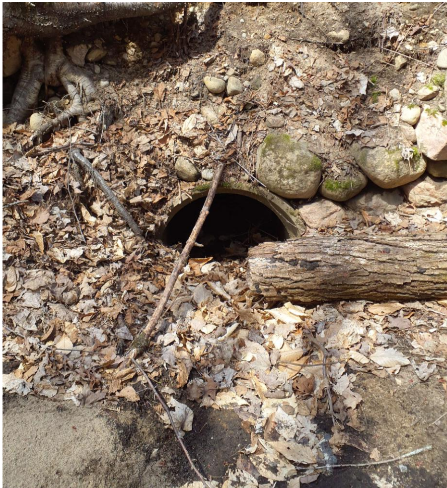
Figure 15 : Ponceau avec 50 % d'obstruction en amont et sans stabilisation adéquate (Lam-Pon-05) au lac Lambert, 2024
