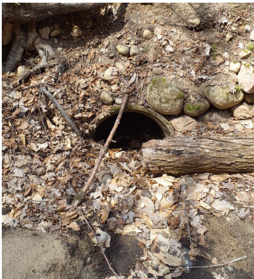
Figure 14 : Ponceau avec 50 % d'obstruction en amont et sans stabilisation adéquate (Lam-Pon-05) au lac Lambert, 2024
