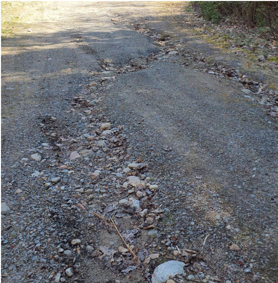
Figure 4 : Exemple de ravinement causé par du ruissellement de surface observé au milieu d'une entrée charretière (Lam-Er-02) au lac Lambert, 2024
