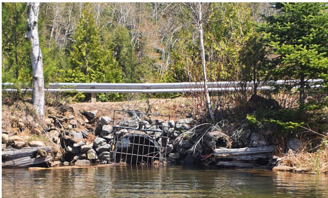
Figure 15 : Ponceau (Lam-Pon-04) avec un manque de stabilisation sur le boulevard Alexandre, au lac Lambert
