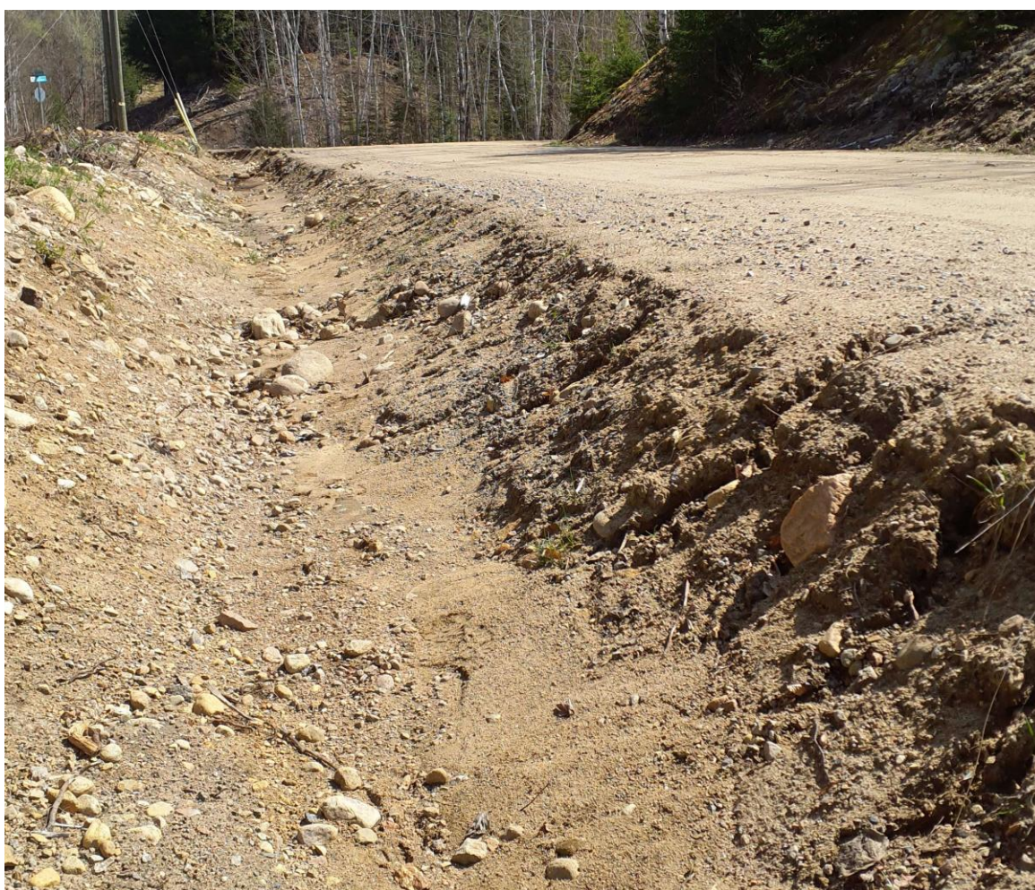
Figure 5 : Exemple de chemin à proximité du lac Lambert subissant de l'affaissement (Lam-Er-06) en raison du manque de stabilisation du fossé, 2024
