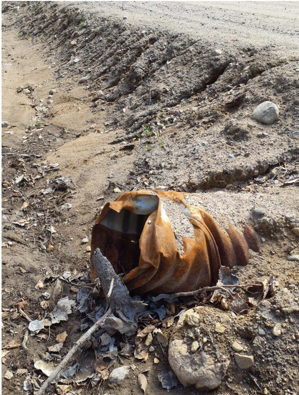
Figure 13 : Exemple de ponceau très détérioré et sans aucune stabilisation (Lam-Pon-02) sur le boulevard Alexandre, lac Lambert 2024
