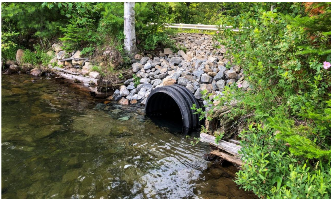
Figure 16 : Réparation du ponceau (Lam-Pon-04) effectuée en été 2024 avec une stabilisation adéquate sur le boulevard Alexandre, au lac Lambert (crédit photo : Catherine Rondeau)
